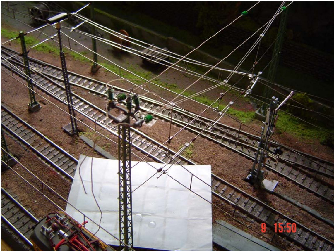
Esempi di mie elaborazioni per rinforzare la linea aerea (Foto n. 15)
