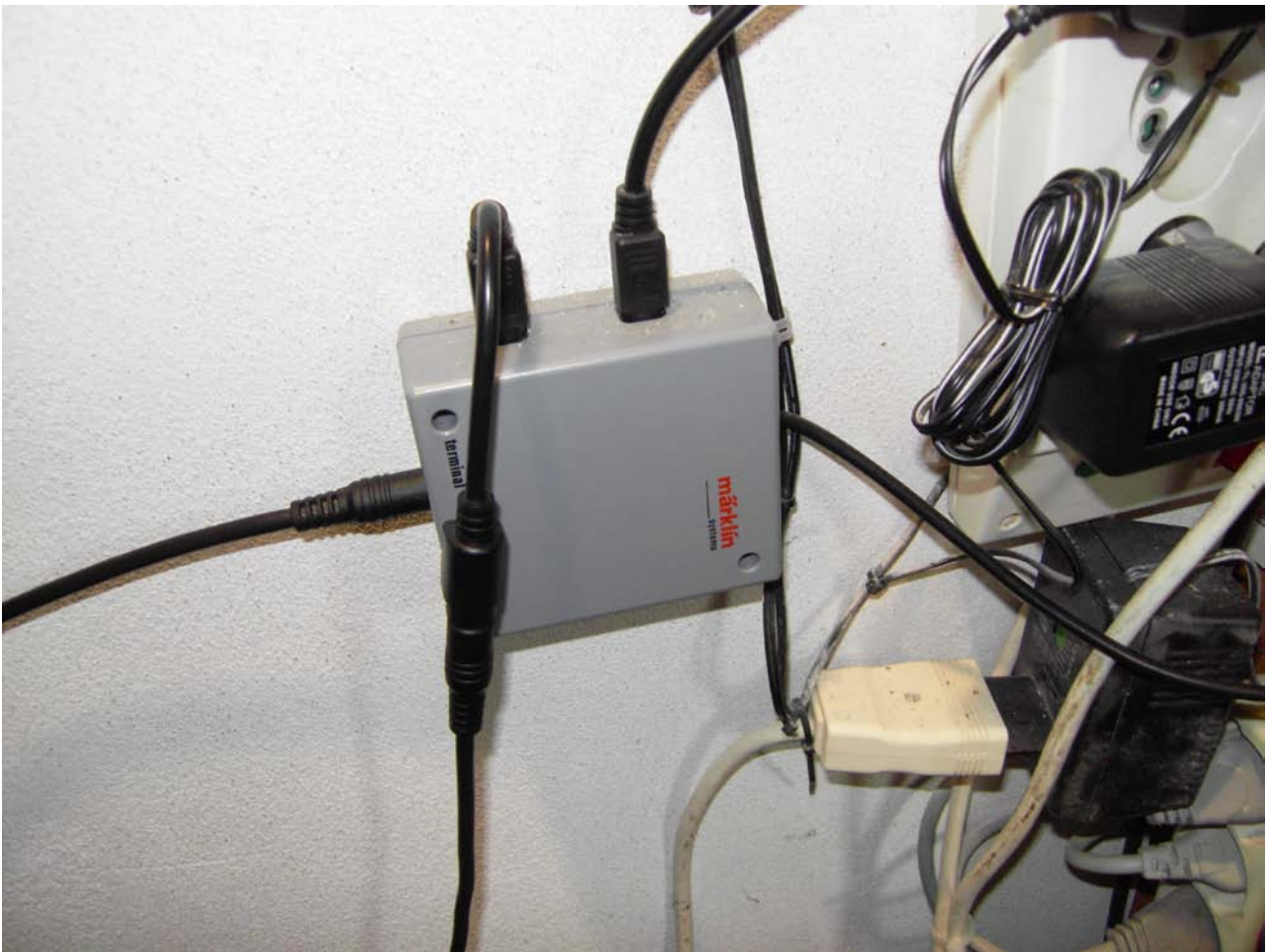
Foto n. 3: uno dei due terminal bus 60125 del plastico di Vibaden. Il cavo a destra proviene dalla Central Station 2, il cavo che va a sinistra è la prolunga 60126
