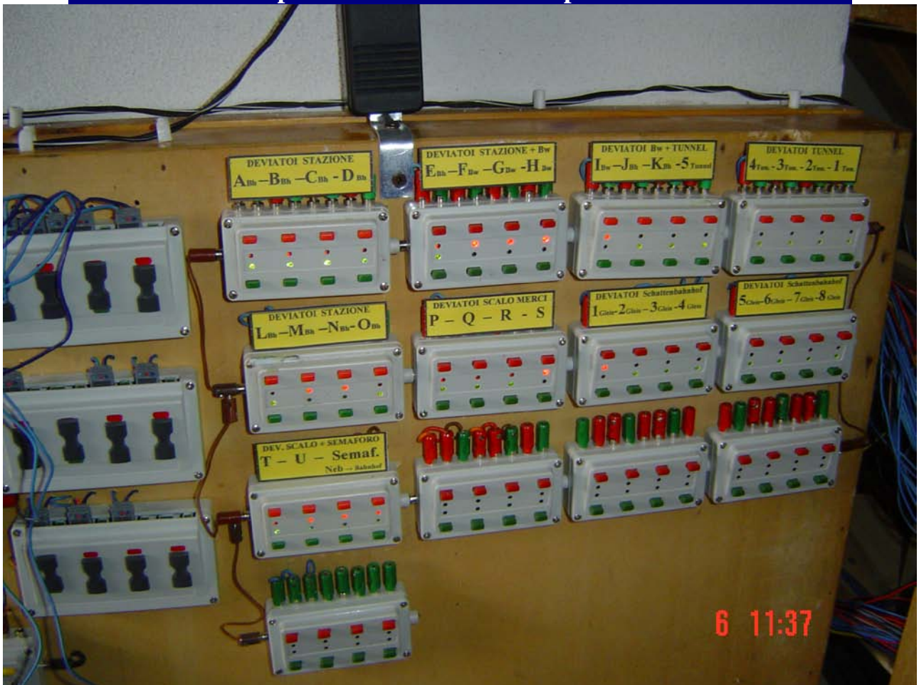
Foto n. 7: banco di comando assolutamente analogico (qui in allestimento)
