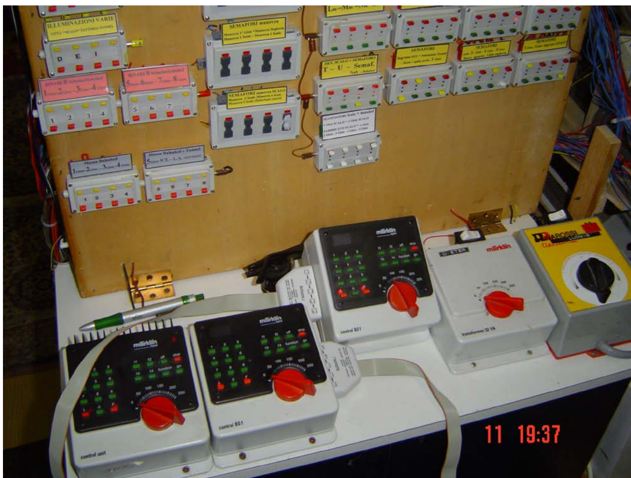
Foto n. 4: Control Unit a sinistra e due F 80 collegati direttamente o da connettore multipolare.
