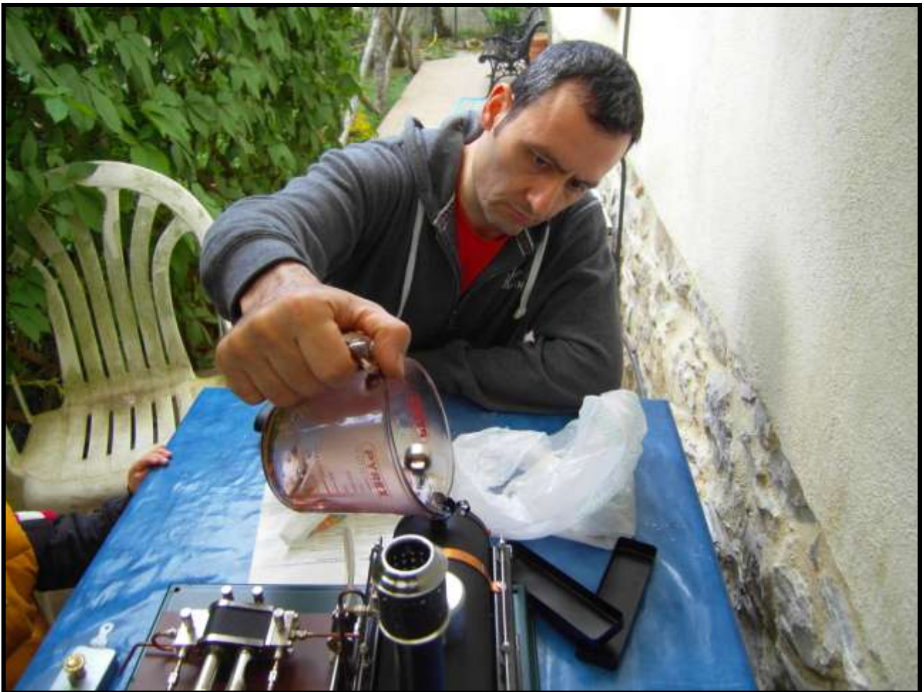
Foto n. 12: la pazienza di mio genero per immettere quasi un litro d'acqua, calda, nella caldaia
