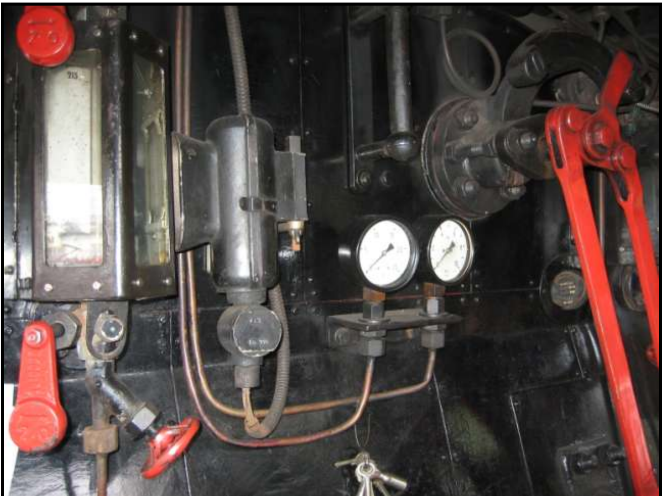
Foto n. 23: Br 58 311, veduta parziale della reale cabina.
